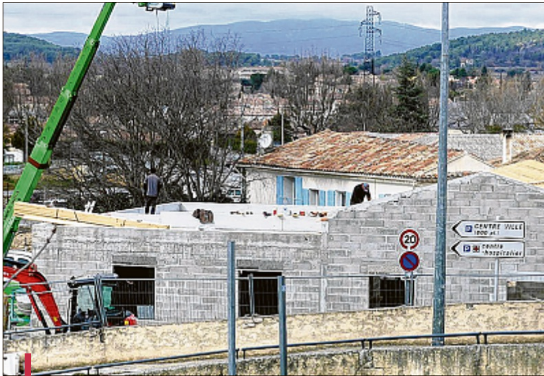
Depuis la mi-octobre, les travaux des futurs locaux du CCAS ont commencé sur le terrain acquis par la commune au parking de la Dévalade, juste à côté de la direction Vie des Quartiers. /PHOTO J.T.
